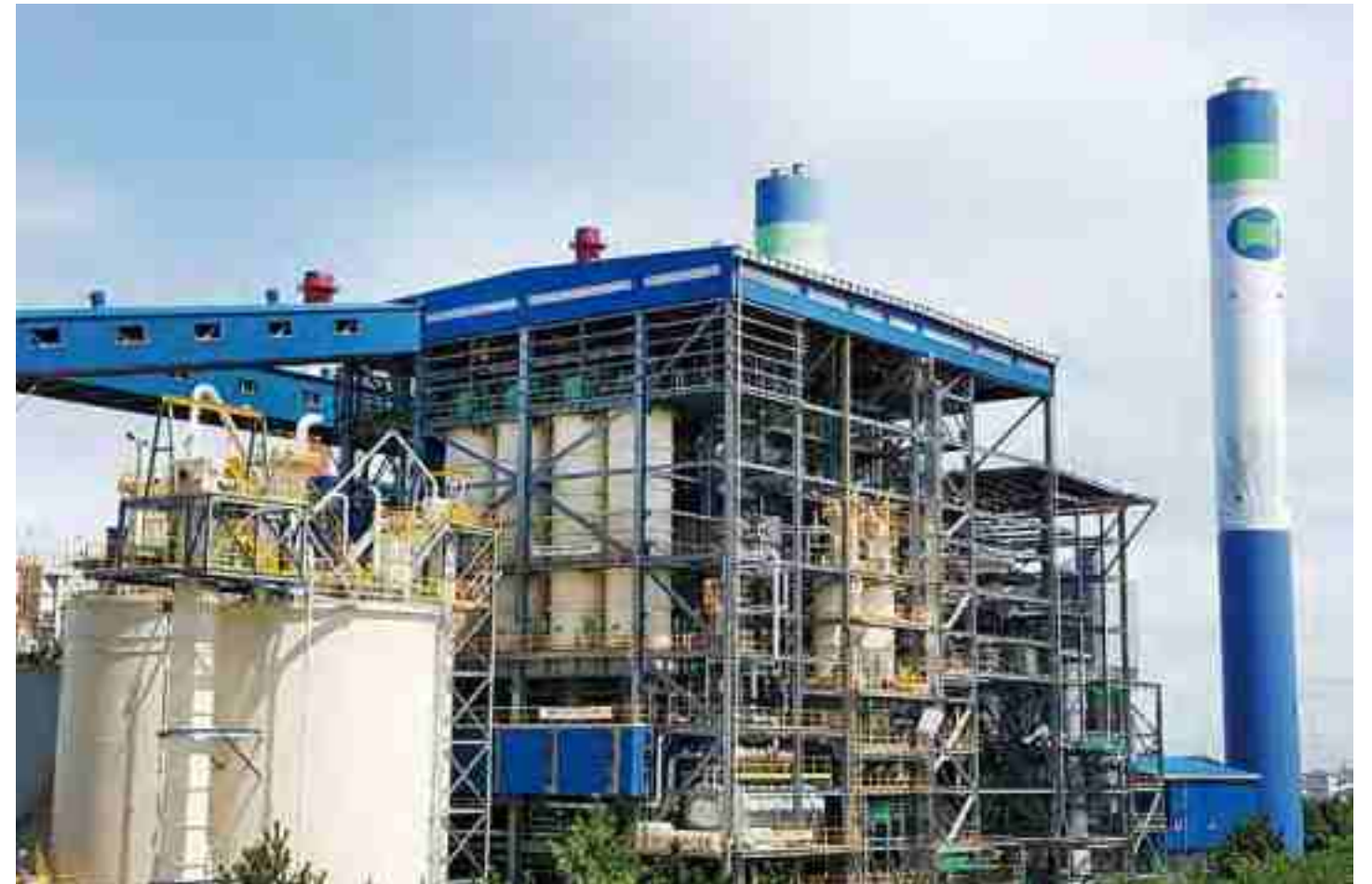
현대오일뱅크 대산공장에 설치한 유동층 연소 보일러(CFBC)
